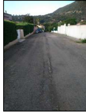
Photo 22 : Vue du revêtement de la chaussée raviné
