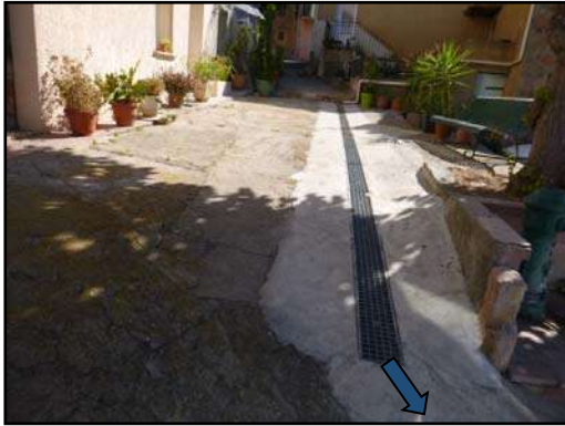
Photo 1 : Vue d'une grille de collecte
