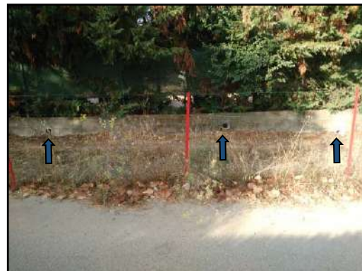
Photo 24 : Vue des trous dans le muret
