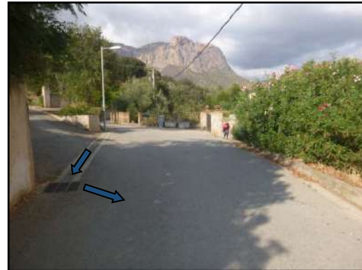
Photo 19 : Vue d'une grille du réseau enterré
