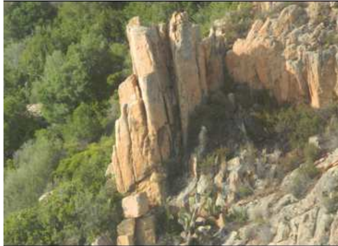
Figure 21: Exemples de rupture possible par basculement de colonnes ou de blocs de volumes décimétriques à pluridécimétriques (en amont de Piscia Rossa)
